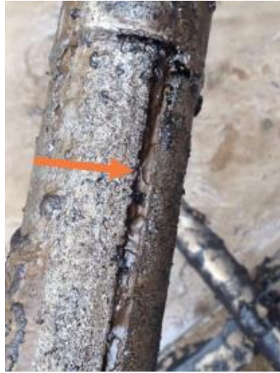
Şekil 1. AISI 316L dikişli boruda korozyona uğramış kaynak dikişi.
